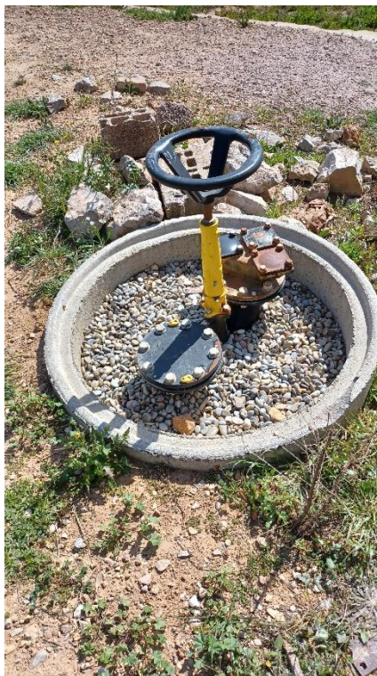
Photo 4 : Installation pour l'irrigation des parcelles (Even)
