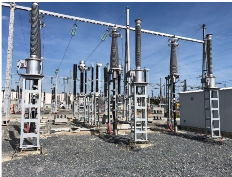
Une cellule de raccordement
