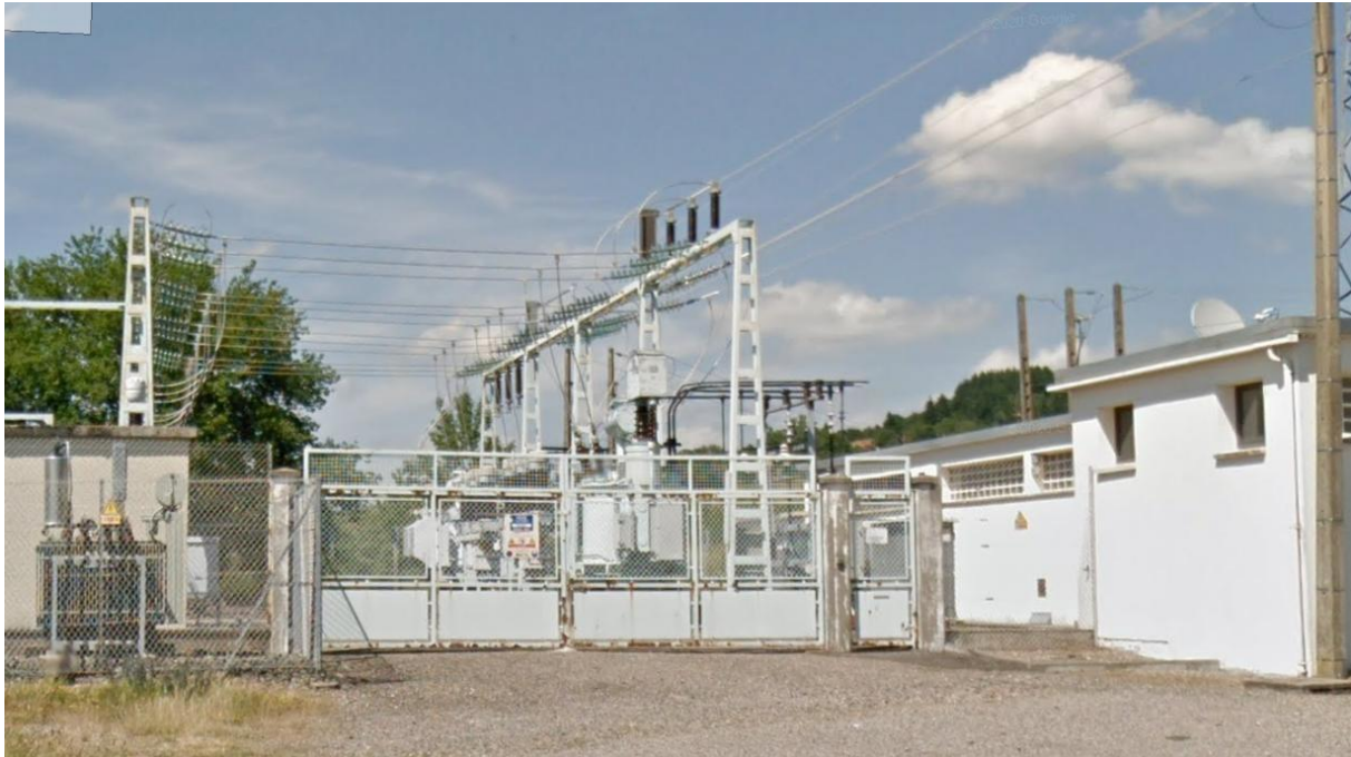
Figure 1 : Vue du poste source
