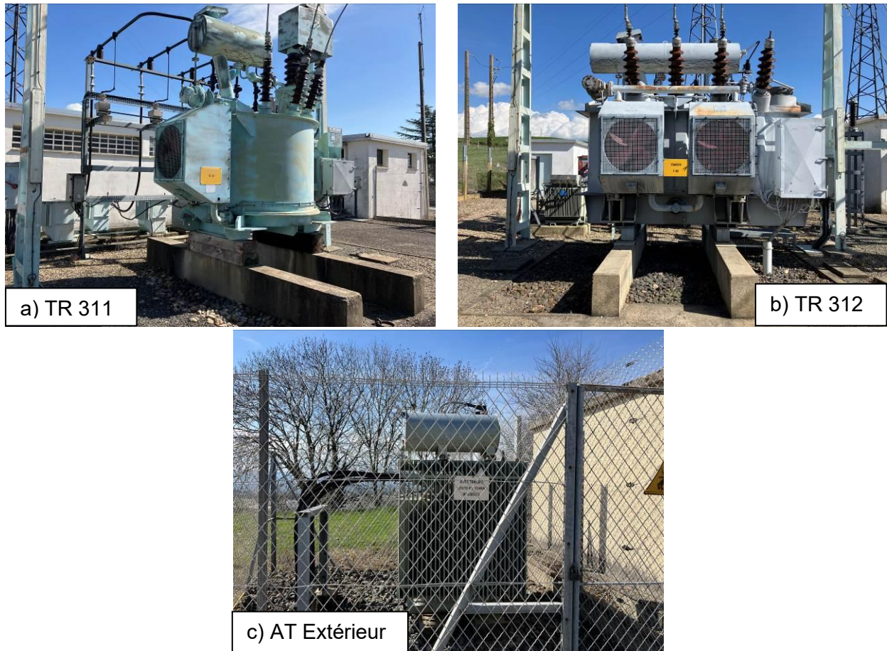
Figure 6 : Transformateurs TR 311 (a), TR 312 (b) et AT Extérieur (c)
