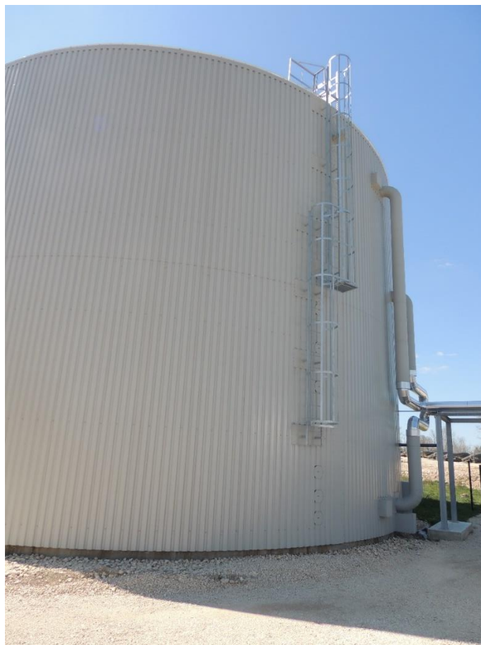
Figure 10 :Exemple de cuve de stockage
