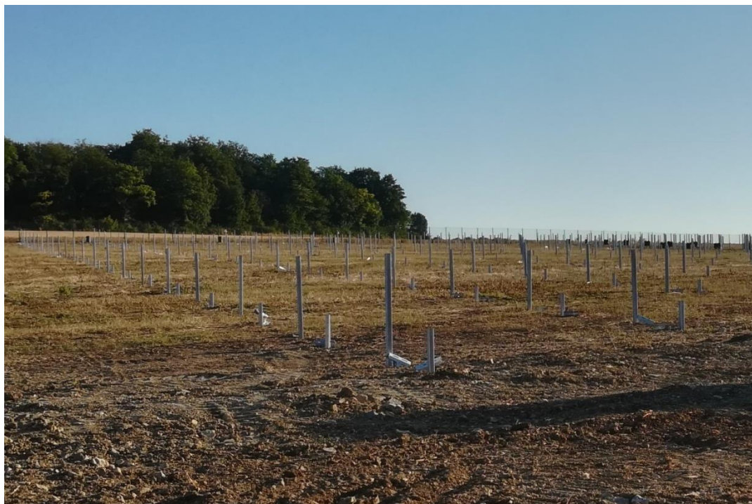
Figure 4 : Photo illustrant les pieux supports des capteurs
