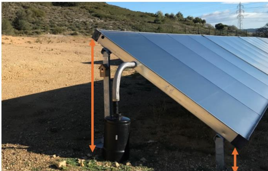
Figure 6 : Capteurs SavoSolar 15 SG montés sur leurs structures fixes en acier galvanisé – Source : NEWHEAT
