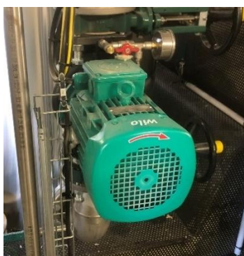
Vue de la pompe
