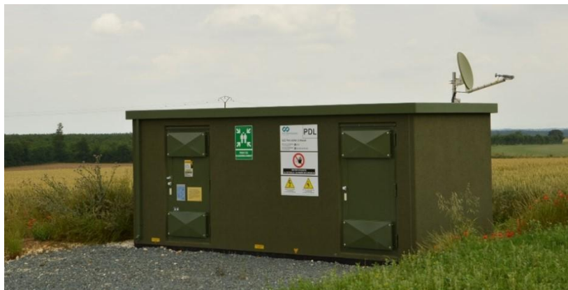
Photographie 5 : Intégration du poste de livraison
