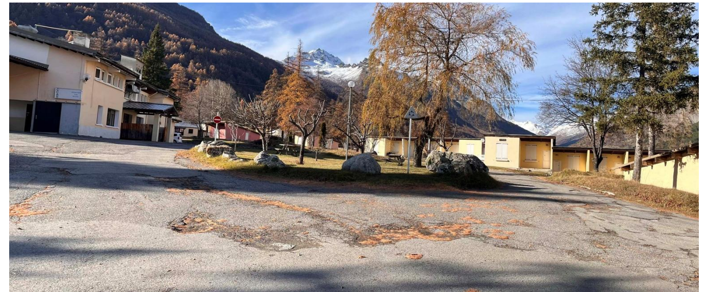
Illustrations des surfaces carrossables au sein du site. Ces dernières restent majoritairement très dégradées.
