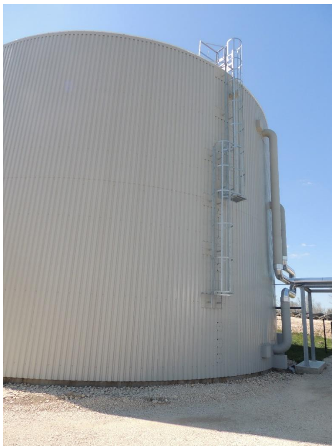
Figure 8 : Exemple de cuve de stockage
