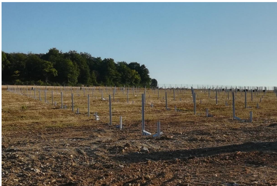
Figure 3 : Photo illustrant les pieux supports des capteurs
