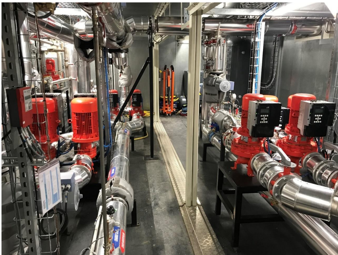
Figure 7 : Exemple d'aménagement intérieur d'une station solaire
