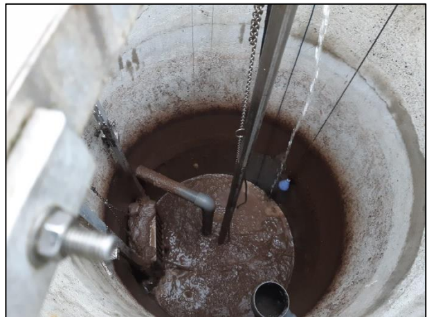
Figure 59 : Présence de flottants dans le poste
