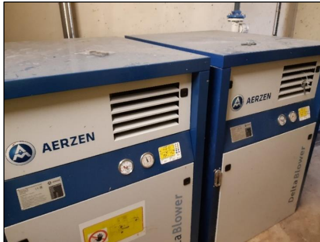
Figure 43 Vue sur les surpresseurs STEP
