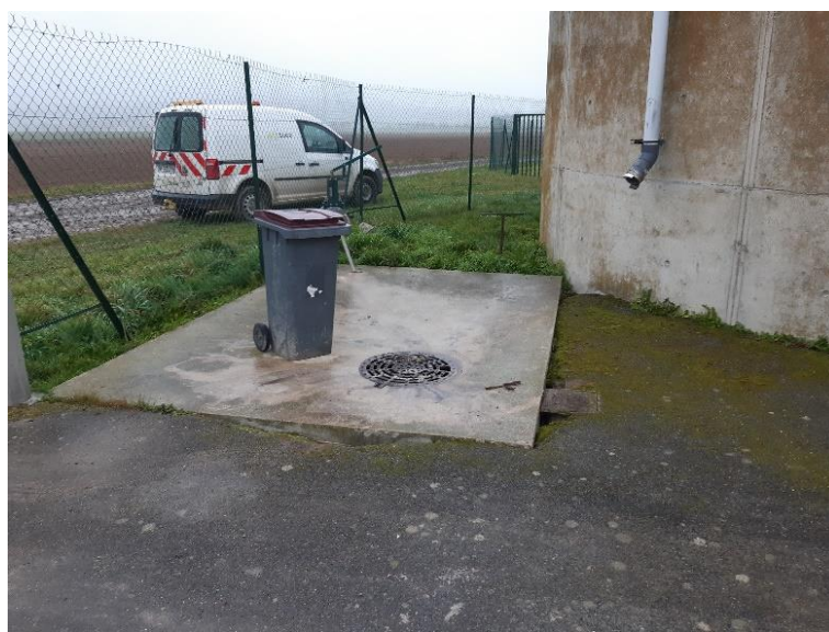
Figure 57 Dalle de soutirage des boues
