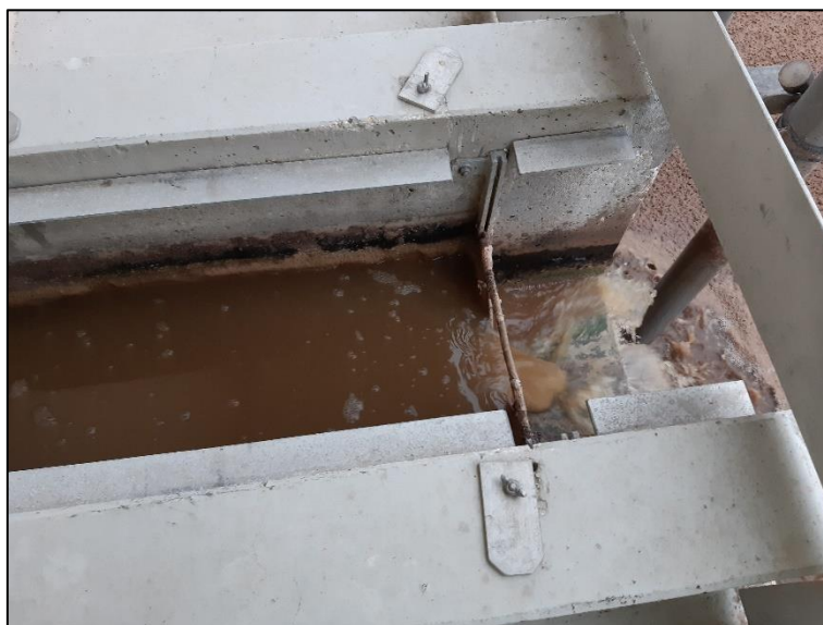
Figure 42 Arrivée dans le bassin d'aération depuis le canal en sortie de dégrilleur/tamiseur
