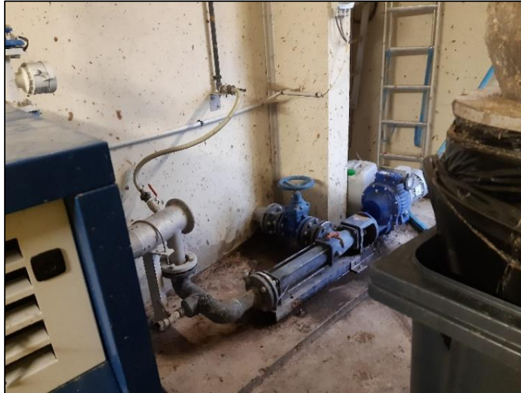
Figure 53 : Pompe volumétrique d'alimentation de la GDD
