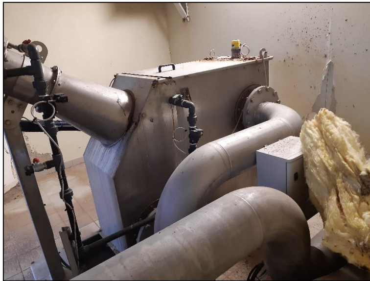
Figure 35 : Prétraitements mis en place
