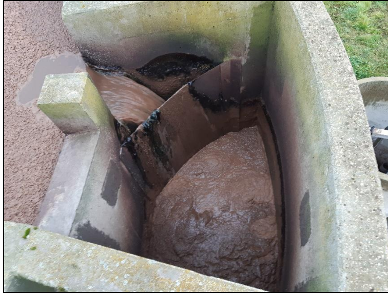
Figure 45 Vue sur le dégazeur
