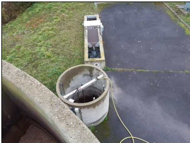
Figure 58 : Vue sur le poste de relèvement interne
