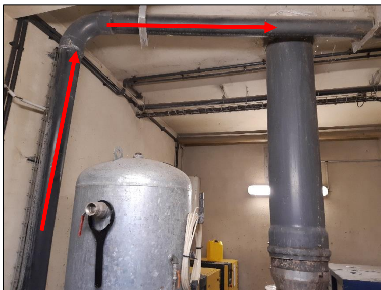
Figure 34 Conduite d'arrivée des eaux brutes dans le local déchet/compresseurs/surpresseurs
