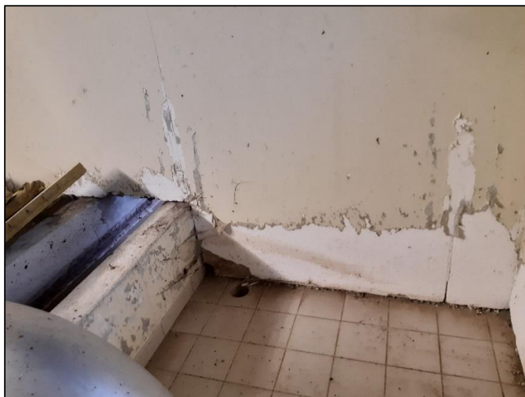
Figure 40 Vue sur les dégradations du mur local
