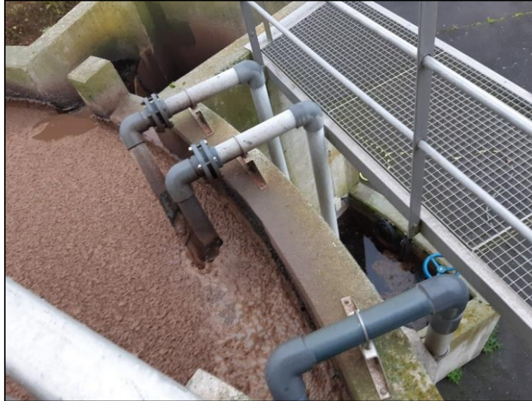
Figure 52 : Puits de recirculation
