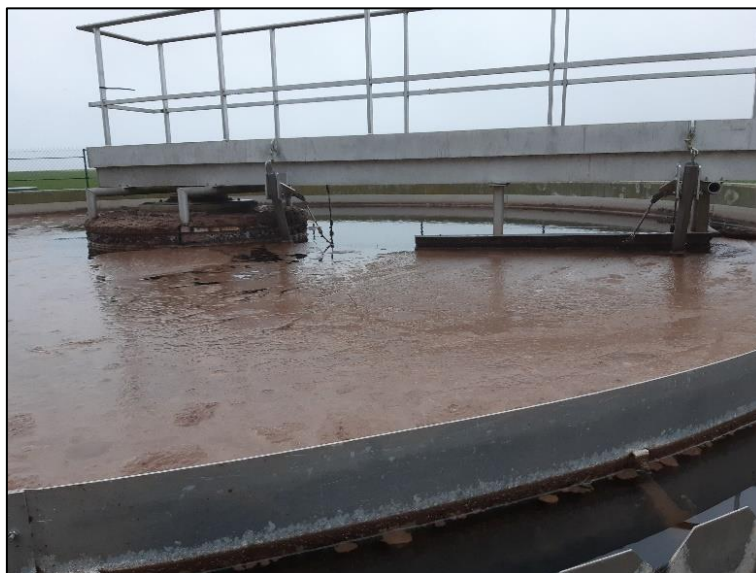
Figure 48 : Clarificateur recouvert de flottants et racle de surface
