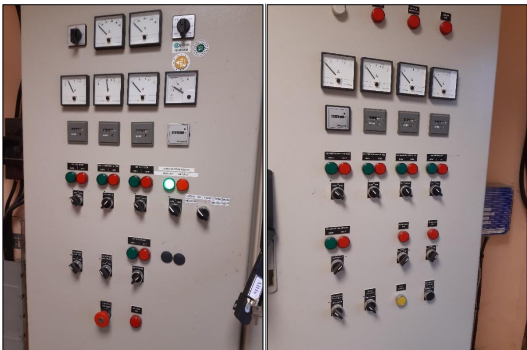
Figure 62 : Façade de l'armoire électrique générale
