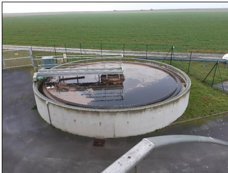
Figure 47 : Vue sur le clarificateur
