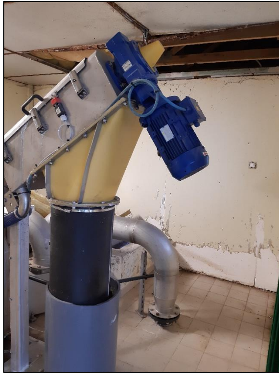
Figure 36 : Zone de compactage et d'évacuation des refus
