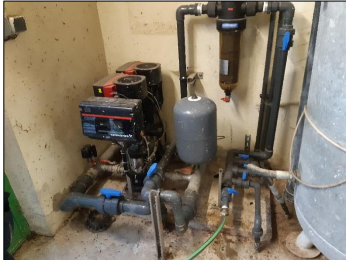
Figure 67 Vue sur le dispositif ERI de la station
