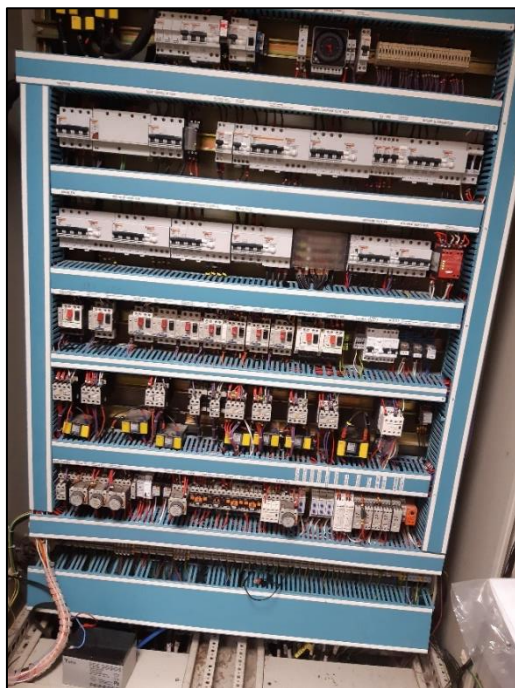
Figure 63 Vue sur l'armoire électrique ouverte
