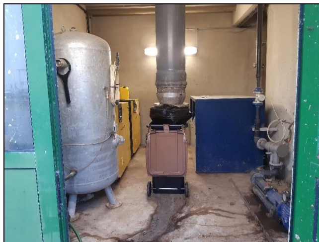
Figure 44 Vue sur le local accueillant les compresseurs des PR et le surpresseur du BA avec la benne à refus de dégrillage
