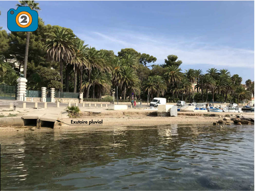
Exutoire pluvial (double) constitué de deux U en béton de 0.8 de large et 0.5 de haut surmontés d'une dalle béton de 10 cm d'épaisseur. Ouvrage non stable.
