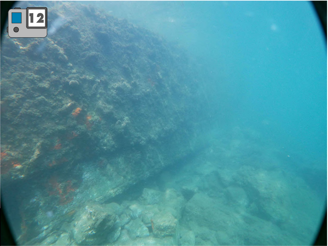
Appontement béton immergé placé de champ venant en appui sur un appontement.
