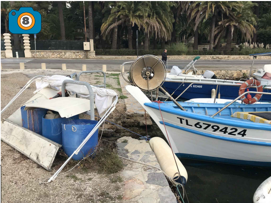
Quai et couronnement sectionnés. Des réparations devront être réalisés à court terme.
