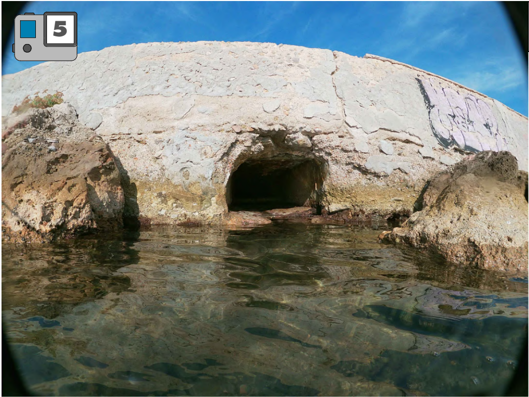
Exutoire pluvial Ouvrage béton rectangulaire de 600 X 400 mm
