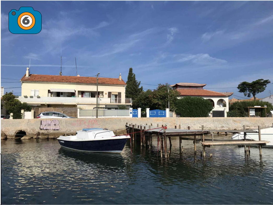
Ponton fixe fondé sur des tubes métalliques de Ø 80 à 100 mm acier et inox avec entretoises en U très corrodés. Cet ouvrage est très accidentogène
