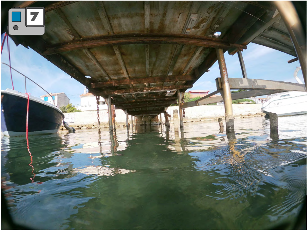
Ponton sur pieux inox de Ø 80 mm et entretoises en U très corrodées.
