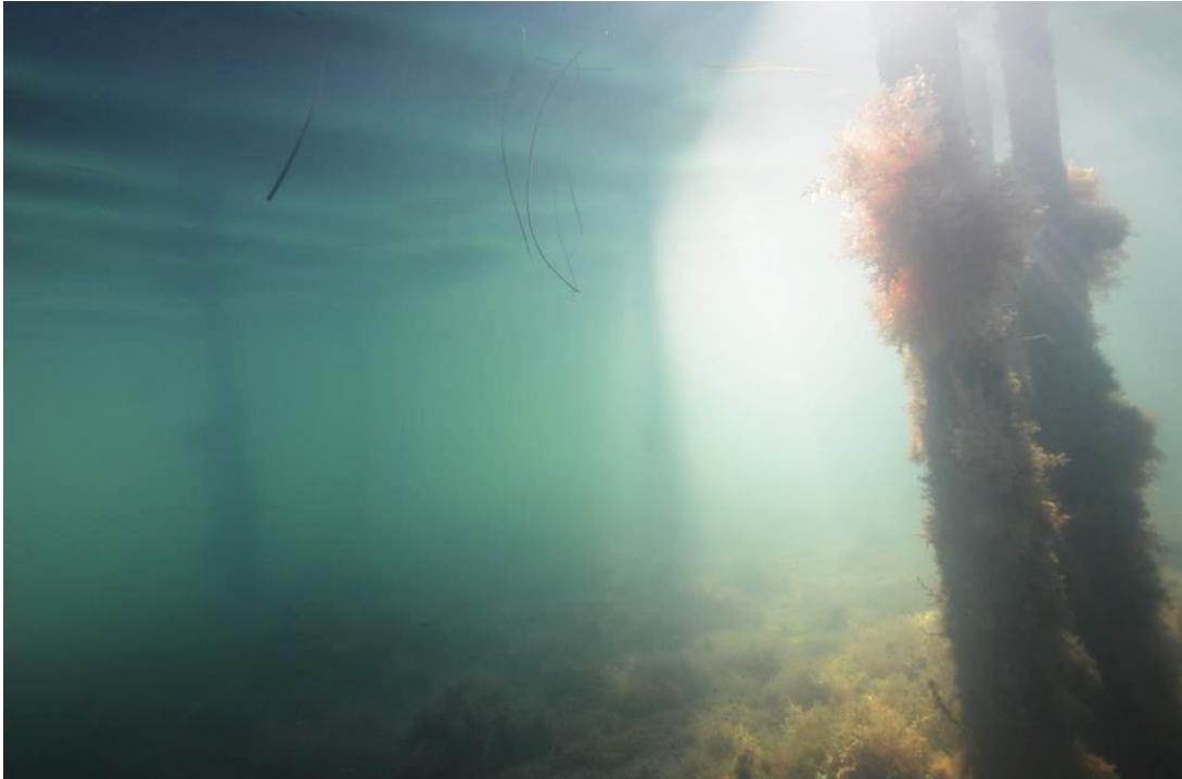
Figure 16 -Ponton isolé avec algues brunes sur les piliers et sur le fonds constitués de cailloutis de ballast © P2A Développement
