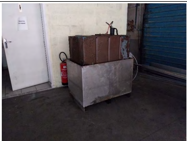
Photographie 15 : Cuve aérienne gasoil 1m³ (ALINOX) (19)
