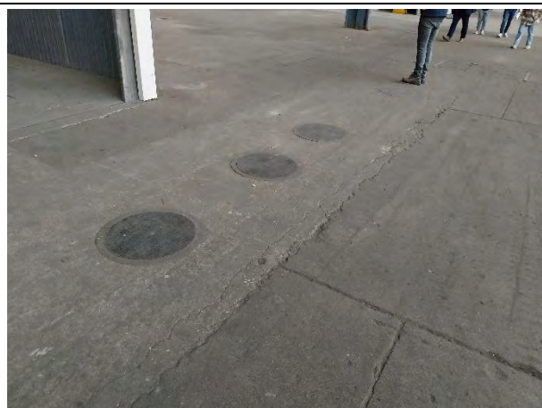
Photographie 11 : Fosse béton compartimentée (Lot 3) (7)
