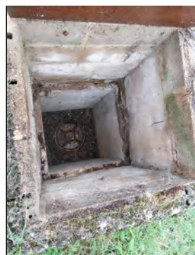
Cuve Enterrée de Hydrocarbures
