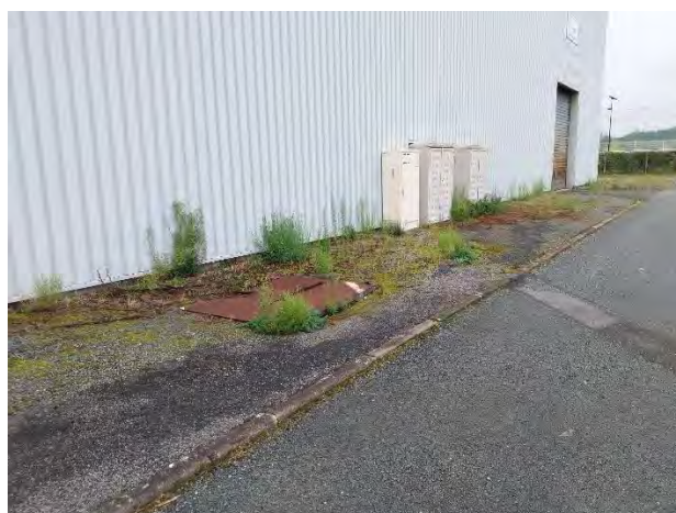
Photographie 22 : Cuve enterrée de fioul (Lot 1) (4)
