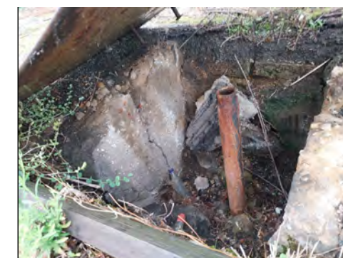
Cuve Enterrée de Fioul
