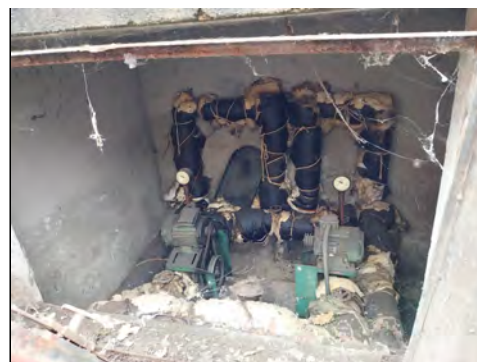
Pompe de refoulement hydrocarbures
