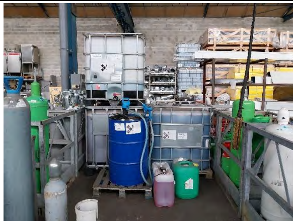
Photographie 20 : Cuve huiles neuves et glycols (Lot 2) (12)
