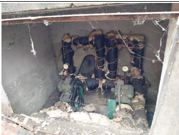
Photographie 5 : Poste pompe hydrocarbures semi-enterré côté ouest (20)
