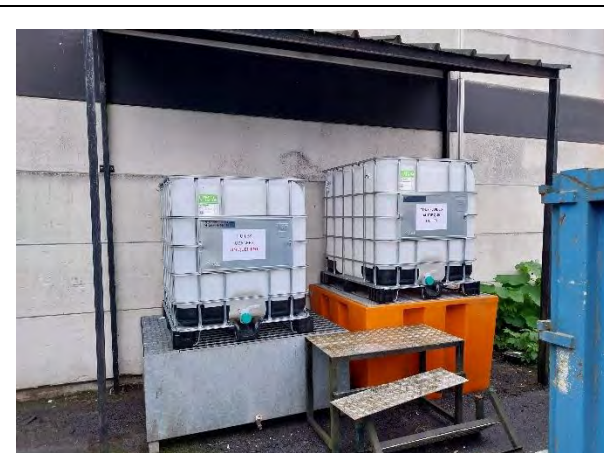
Photographie 18 : Cuves d'huiles usagées (AXIMA) (5)
