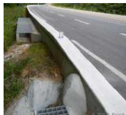
Figure 14. Batrachoduc et glissière béton (source : Société Herpétologique de France)
