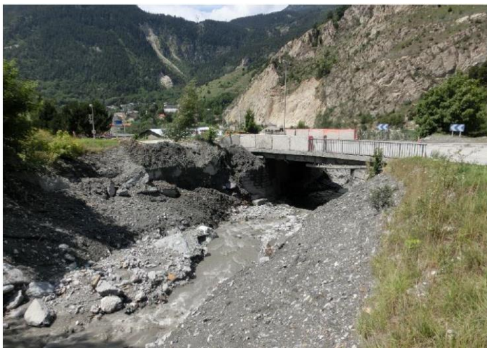
Figure 9 : Pont de la RD1006 après la crue de 2014 (Source : AVP Phases 1 et 2 – Etude hydraulique)
