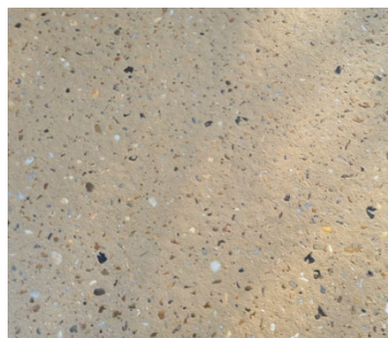
Béton beige exfolié
