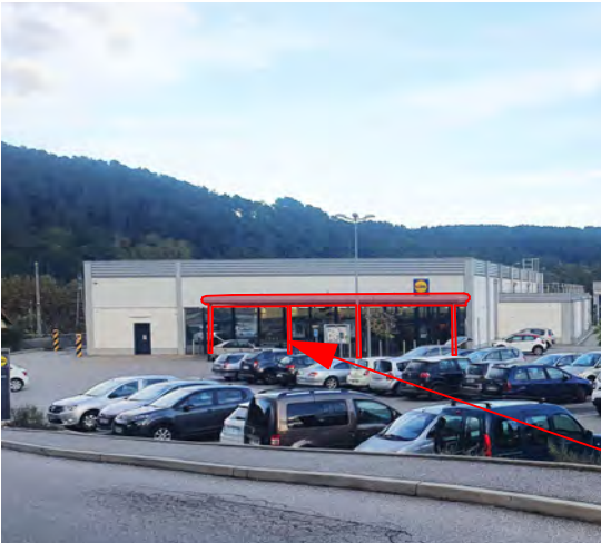
vue auvent démoli
