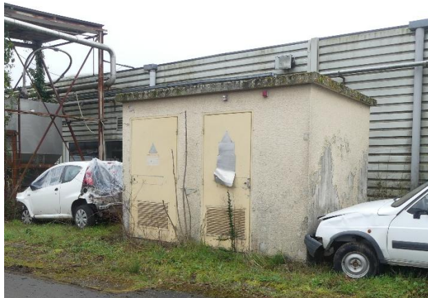
Poste HTA/BT au nord site (ECTARE, février 2026)
