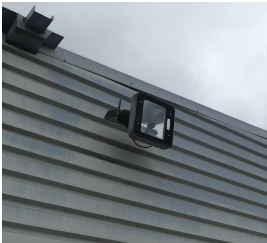
Panneaux d'éclairage sur le bâtiment situé sur les terrains d'étude (ECTARE, février 2026)
