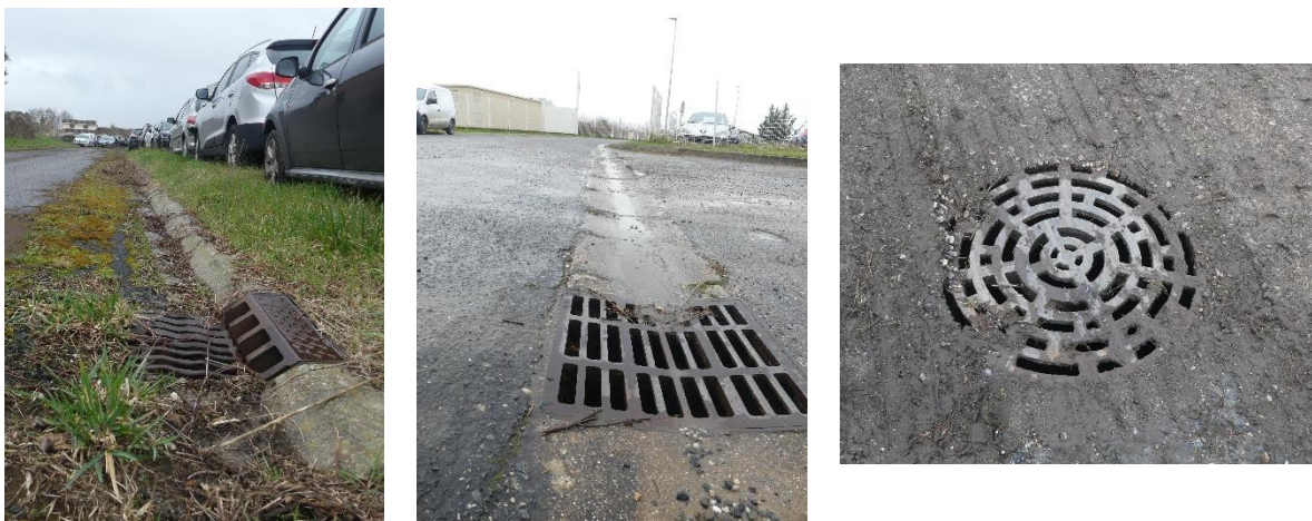
Avaloirs d'assainissement des EP sur le site d'étude (ECTARE, février 2026)
