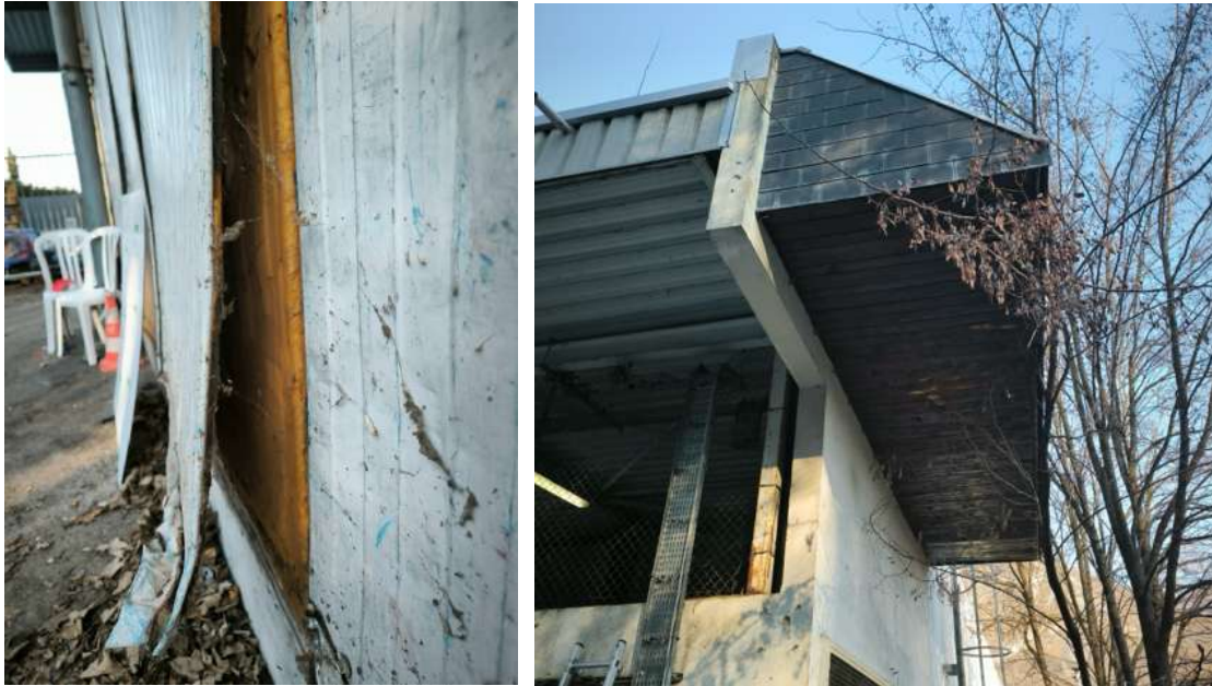
Bardage métallique présentant des défauts et avancée en bois susceptibles d'accueillir des chauves-souris
