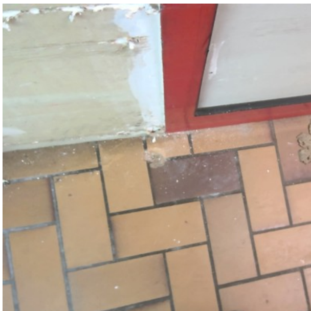
N RDC / LOCAL TECHNIQUE / Colle + Joint de carrelage + Ragrée [ Prélèvement n°40]
