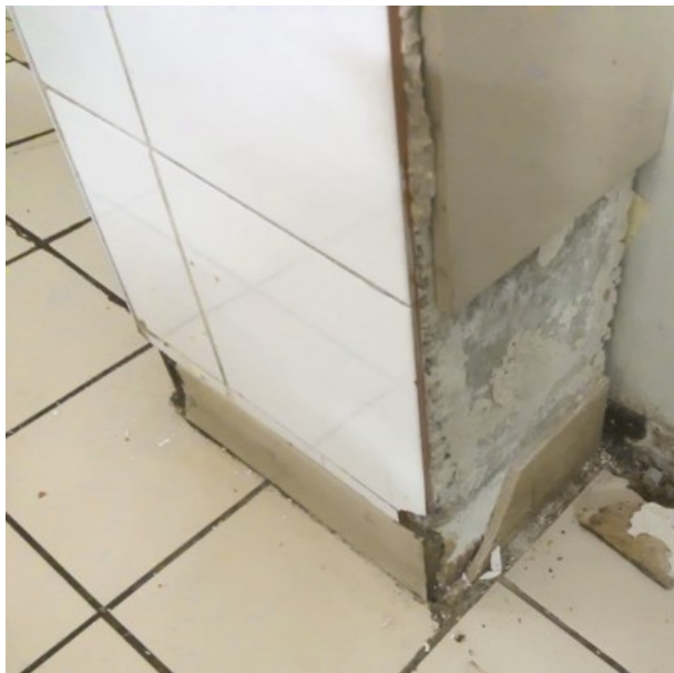
N RDC / SURFACE DE VENTE / Colle de plinthe (fromager/boucherie) [ Prélèvement n°78]
