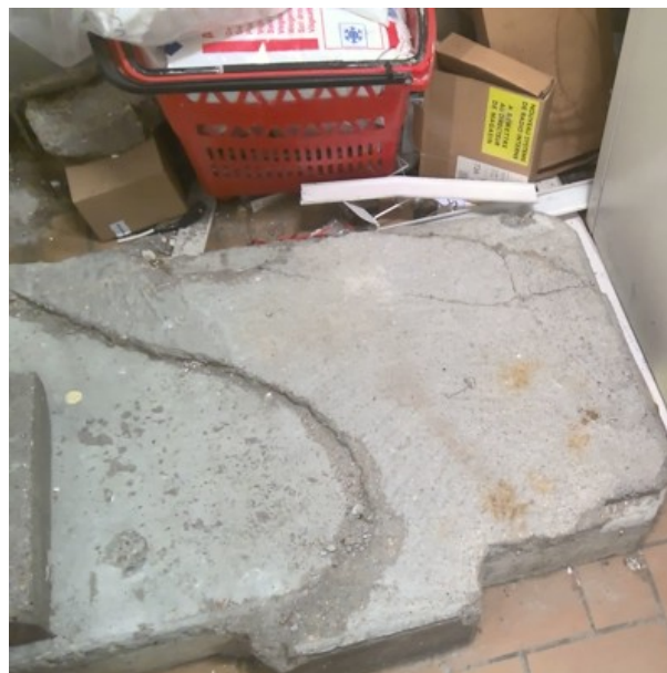
N RDC / LOCAL TECHNIQUE / Massif béton + Ragrée [ Prélèvement n°44]
