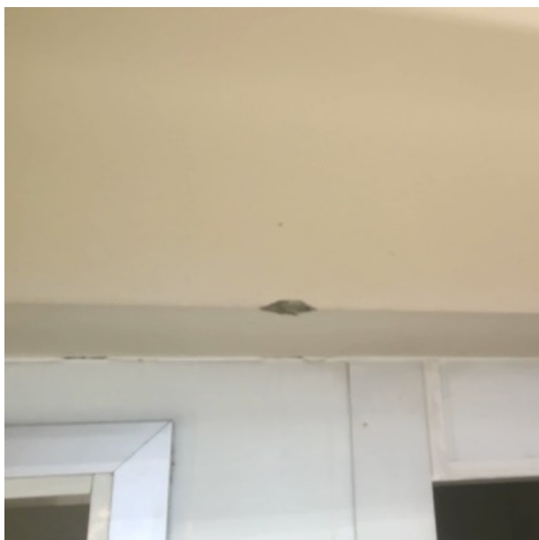
N RDC / SURFACE DE VENTE / Peintures + Enduit type ciment (poutres) [ Prélèvement n°80] [ Idem Prélèvement n°62]
