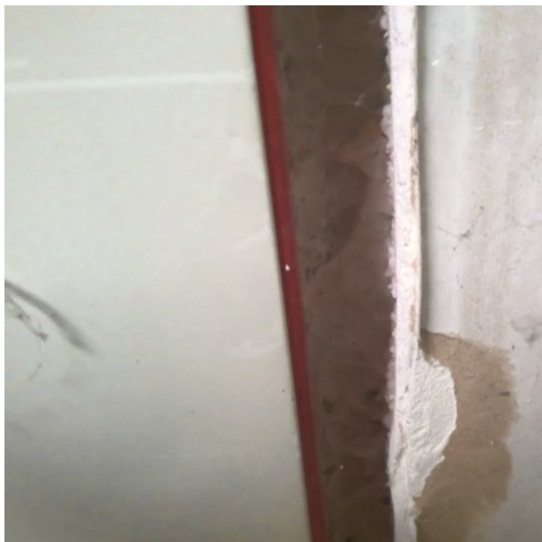
N RDC / LOCAL TECHNIQUE / Plot de colle [ Prélèvement n°45]
