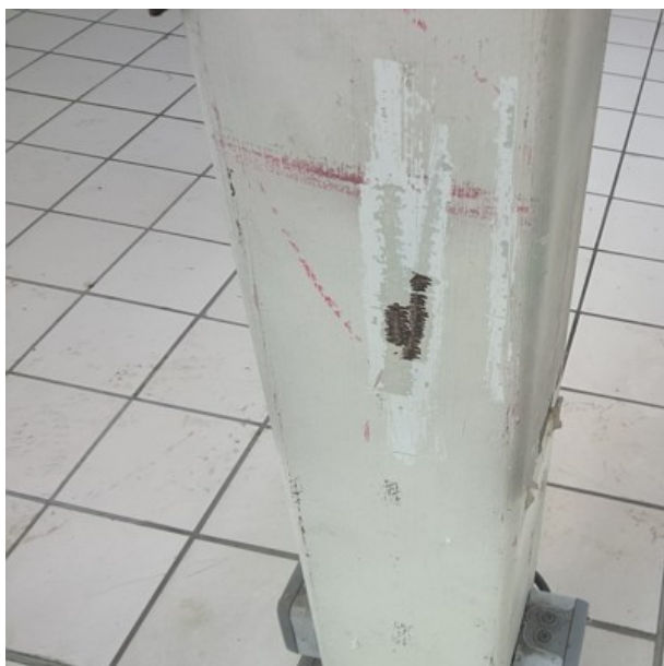
N RDC / SURFACE DE VENTE / Peintures sur poteau métal [ Prélèvement n°68]
