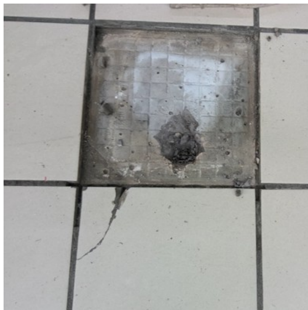
N RDC / SURFACE DE VENTE / Colle + Joint de carrelage (sup) [ Prélèvement n°66] [ Idem Prélèvement n°53]
