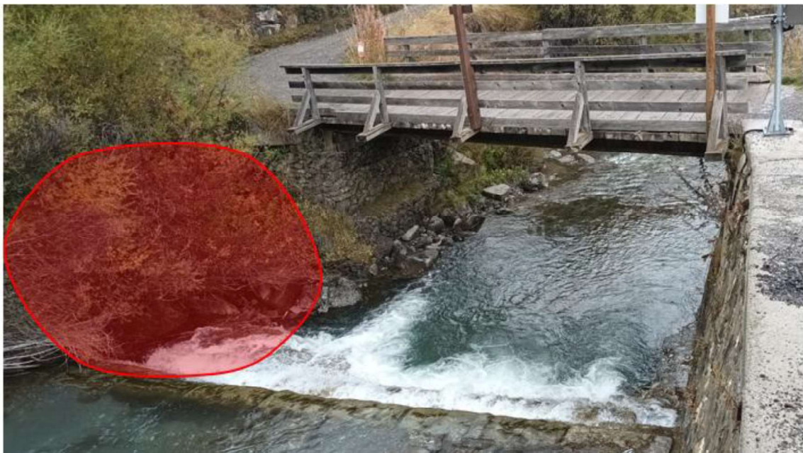
Figure 6 : Zone d'érosion à épauler par enrochements bétonnés
