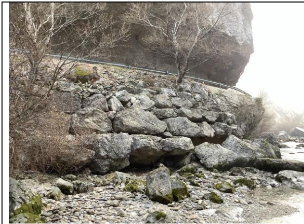
Effondrement des blocs et affouillement
