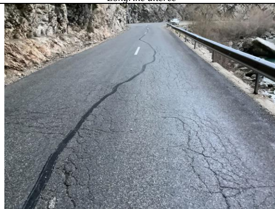
Faïençage de la chaussée
