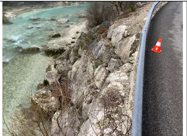
Effondrement des blocs et végétation
