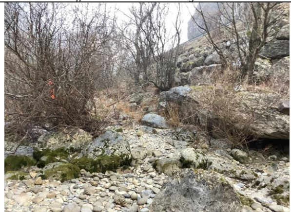
Végétation en pied de mur
