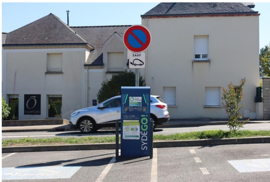
Photo 16. Borne de recharge située au carrefour de l'impasse du liquidambar et de la RD 26 à Grandchamp-des-Fontaines
