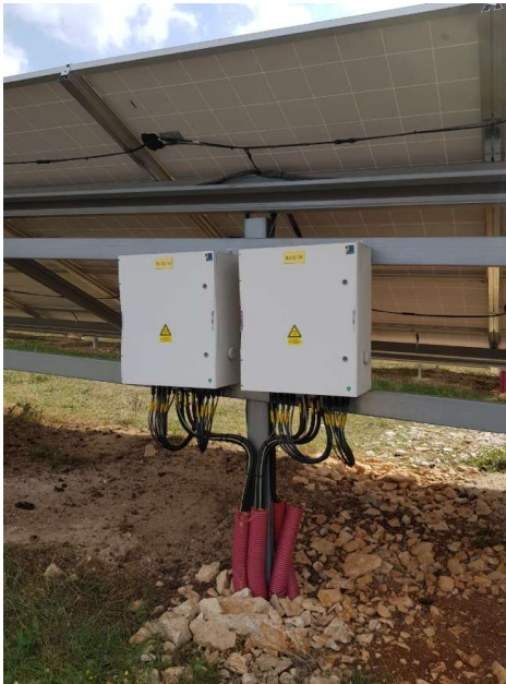
Figure 27 : Onduleur string (source TSE)
