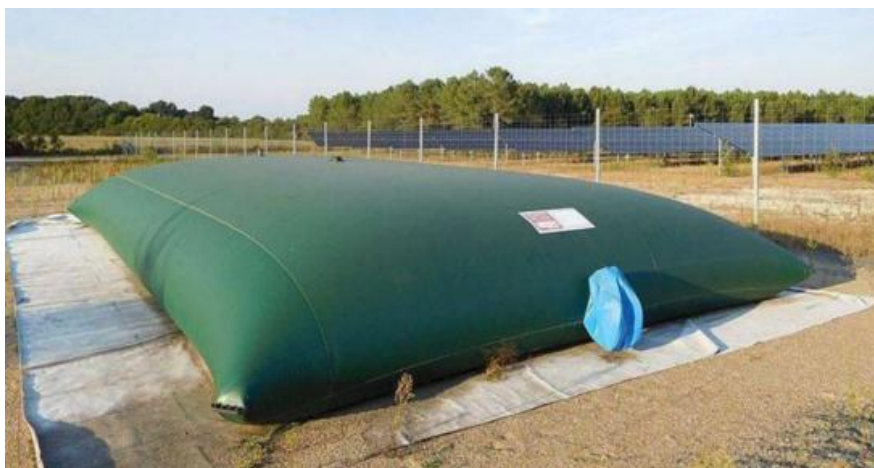
Figure 23 : Exemple de citerne souple autoportante d'eau de défense incendie
