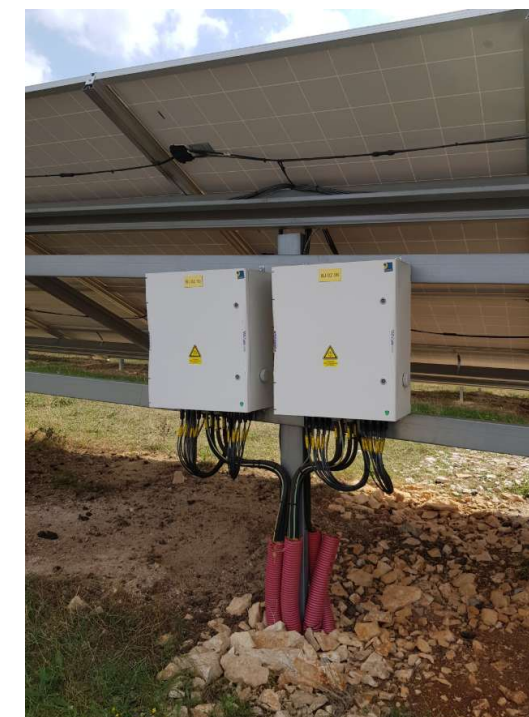
Figure 17: onduleur string (source TSE)
