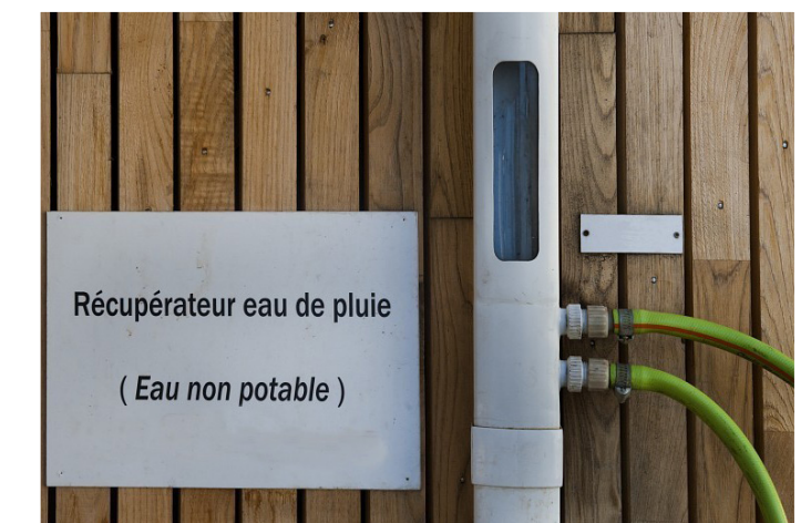
Récupération d'eau de pluie
