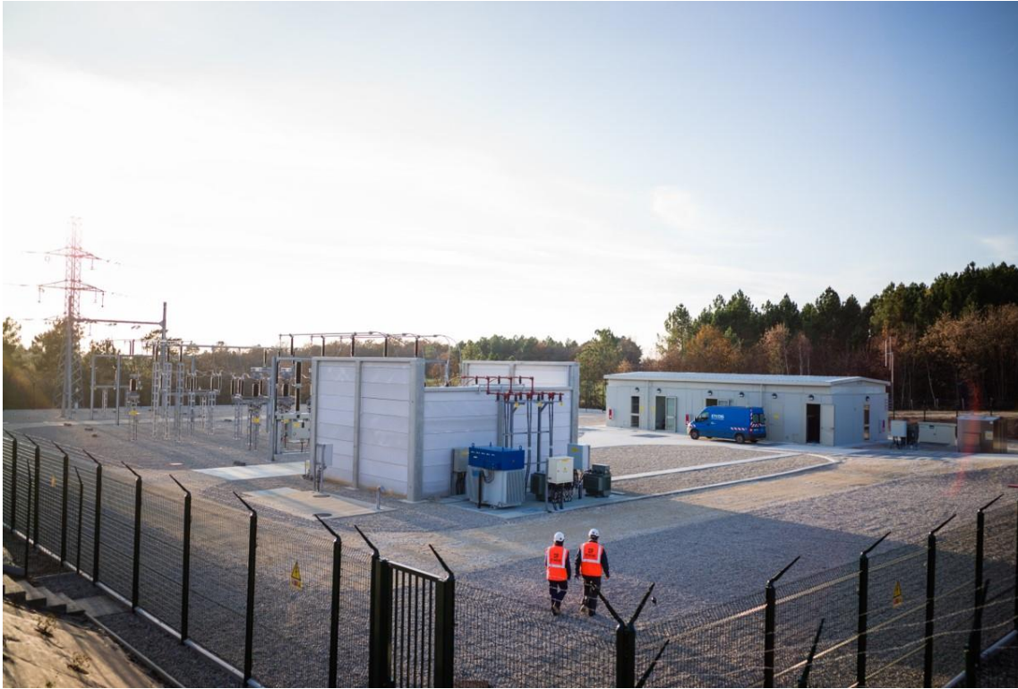
Exemple, le poste source de Manoire sur la commune de Fossemagne (24), route de la maison forte
