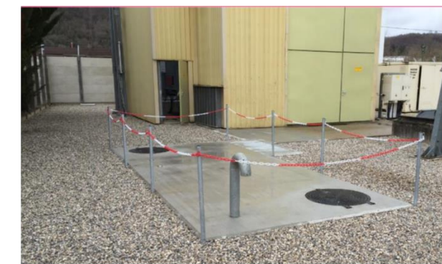
Photo exemple d'une fosse déportée (source ENEDIS)
