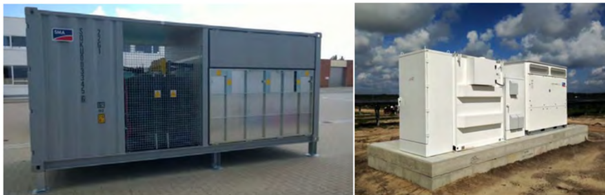
Exemples de postes de transformation « container » ou « outdoor »
