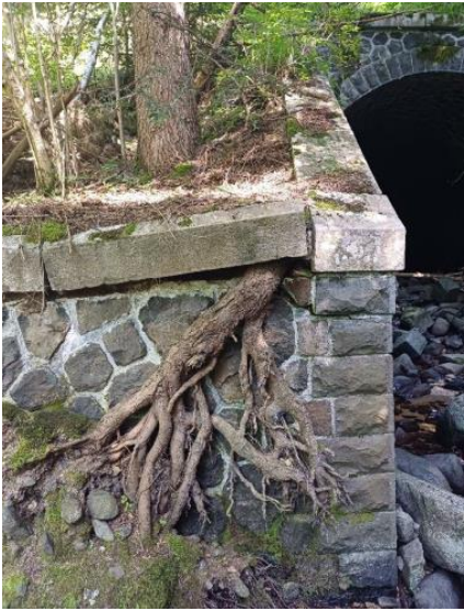
Photo 32 : Racines désorganisant la maçonnerie du mur (OH35)
