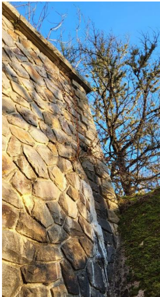
Photo 1 : Arbre dans la maçonnerie de la tête
