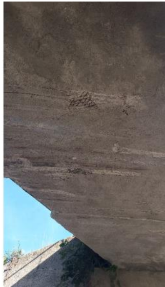
Photo 30 : Eclats de béton avec aciers apparents et éclats de béton en formation en intrados du tablier
