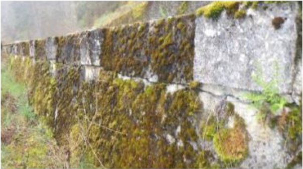
Photo 20 : Fracture horizontale sous la corniche et présence de mousse en grande quantité
