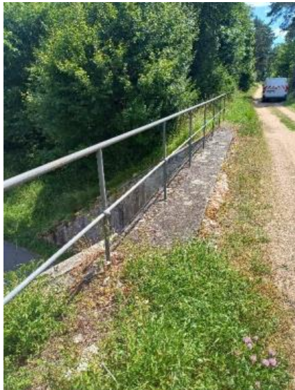
Photo 29 : Garde-corps non réglementaires à remplacer
