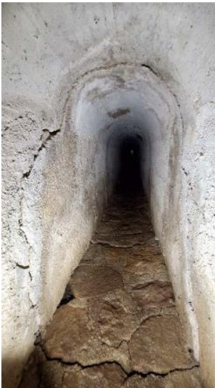
Photo 33 : Multiples fractures dans le radier, les piédroits et la voûte de l'ouvrage, ouvrage à chemiser (OH25)
