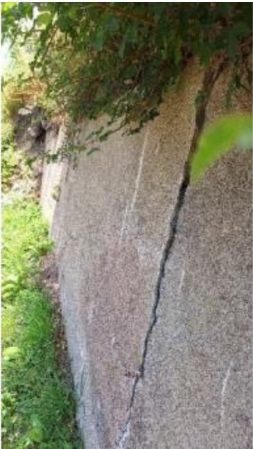
Photo 242 : Fracture avec rejet, à injecter et clouer
