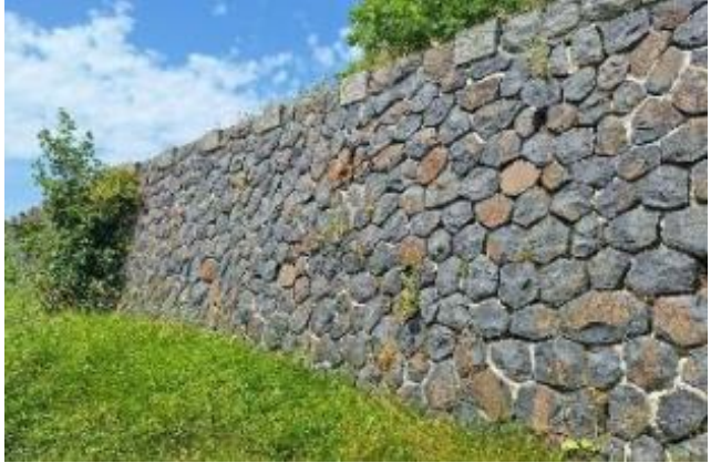
Photo 23 : Joints de maçonnerie à réfectionner
