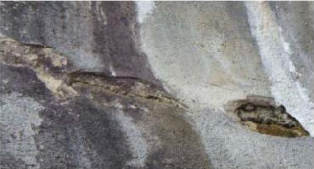
Photo 21 : Fissures à injecter
