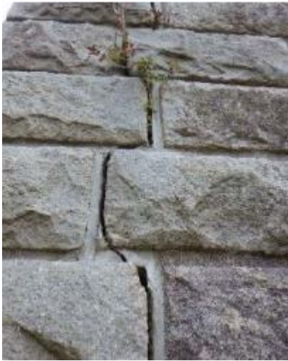
Photo 14 : Fissuration d'une chaîne d'angle
