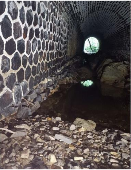
Photo 31 : Affouillements et disjointements en base de piédroits, affouillements au centre de l'ouvrage (OH35)
