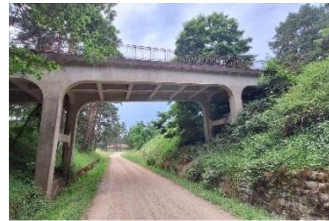
Photo 26 : Passage supérieur à sécuriser
