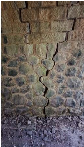
Photo 28 : Fracture transversale importante en voûte et se prolongeant sur les piliers.
