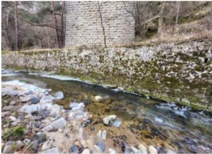
Photo 15 : Affouillement en pied de pile du viaduc des Badioux
