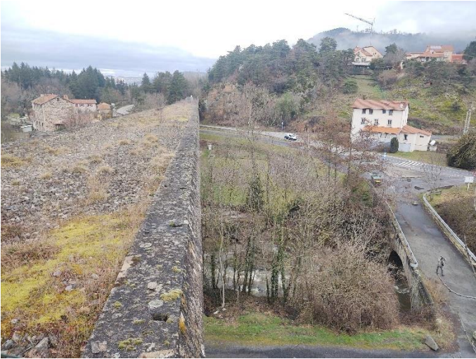
Photo 16 : Viaduc de Peyrard sans garde-corps à l'existant
