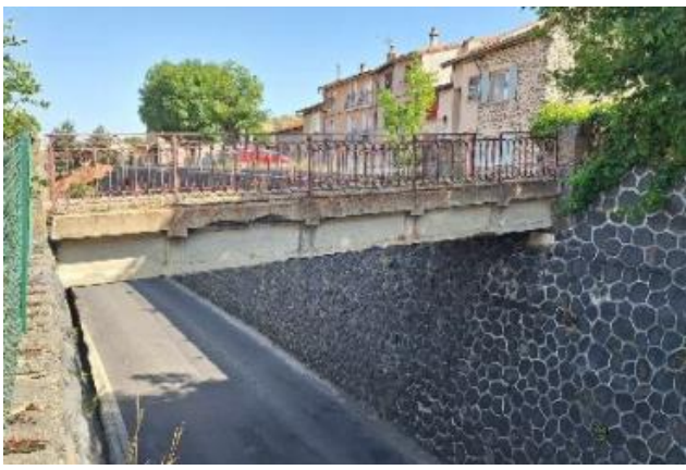
Photo 27 : Passage supérieur à réparer
