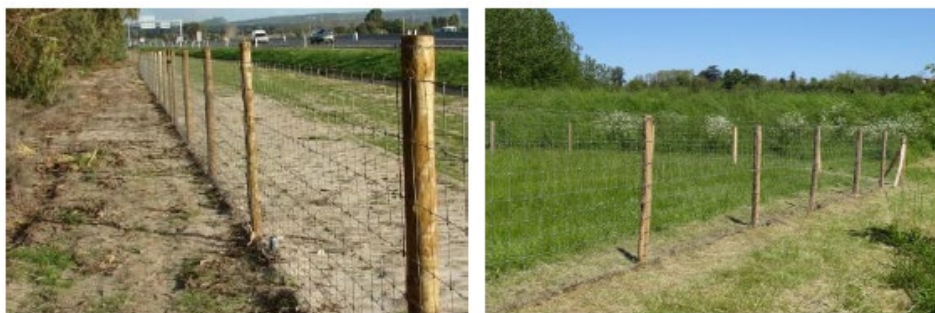
Figure 12 : Exemple d'une clôture de parc solaire
