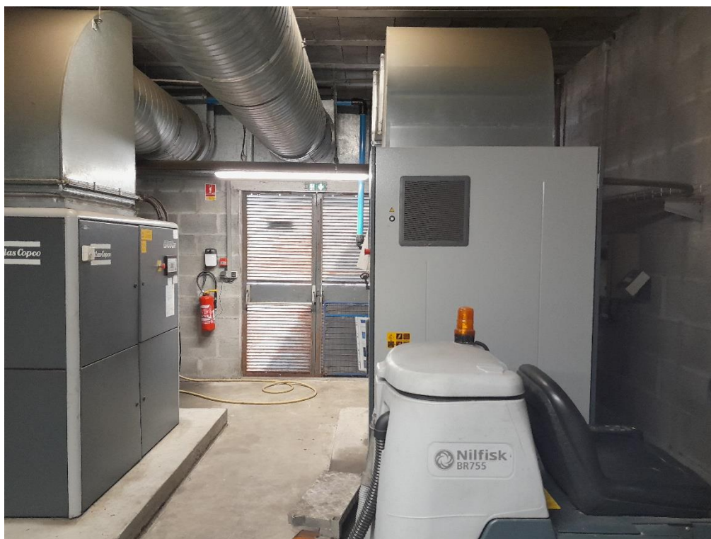
PHOTOGRAPHIE DU LOCAL COMPRESSEURS
