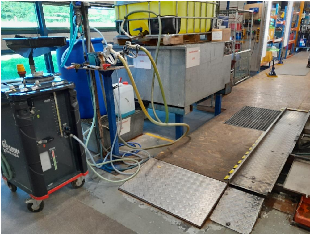
PHOTOGRAPHIE DE LA ZONE DE DISTRIBUTION DE FIOUL
