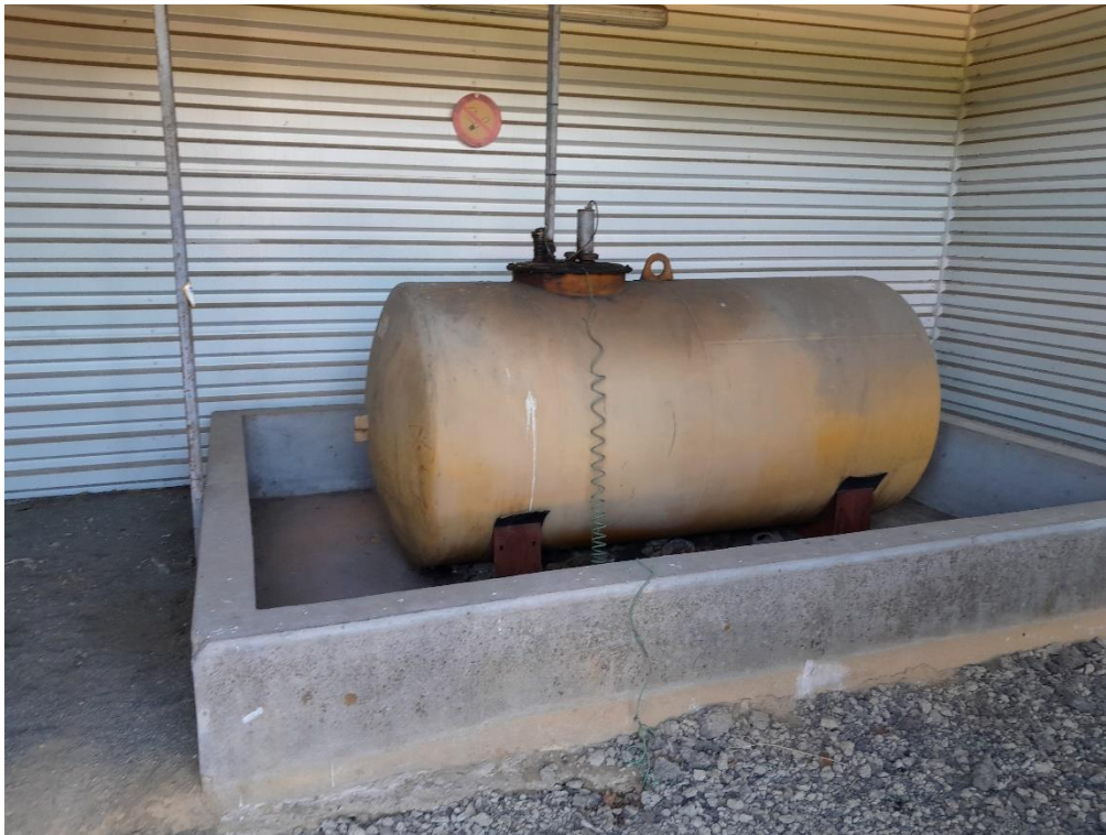
PHOTOGRAPHIE DE LA CUVE AERIEENNE DE 3 000 LITRES DE FIOUL
