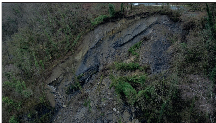
Figure 4. Zone de décrochement de l'éboulement rocheux
