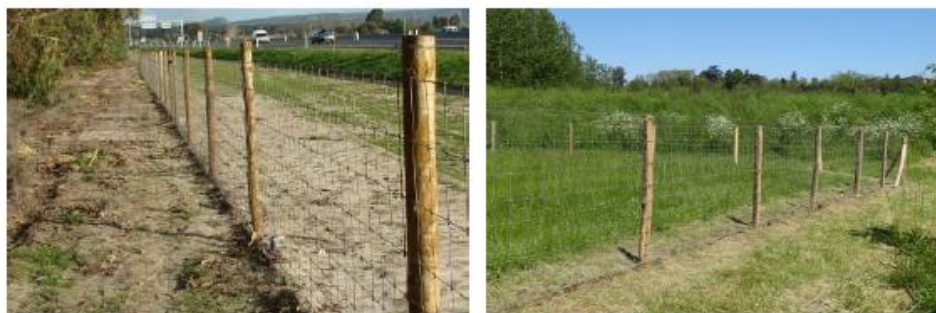
FIGURE 1 : EXEMPLE D'UNE CLOTURE DE PARC SOLAIRE – SOURCE MELVAN
