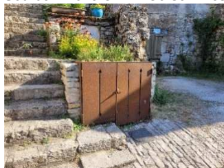
Exemples – compteur électrique
