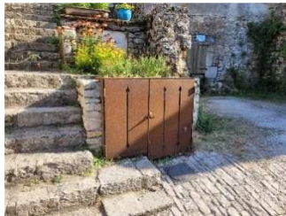
Exemples – compteur électrique
