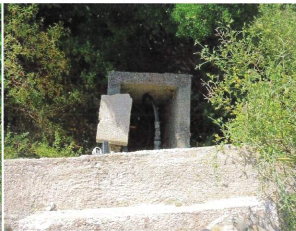
Regard-Vannes en entrée-sortie du réservoir
