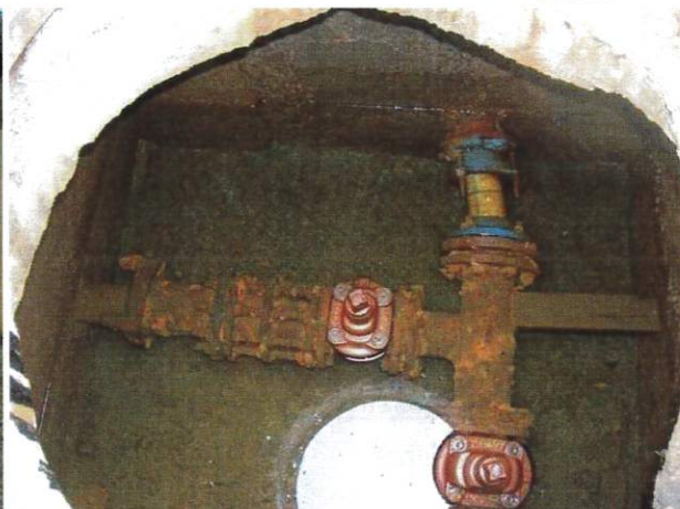
Regard-Vannes sur l'adduction en entrée-sortie du réservoir
