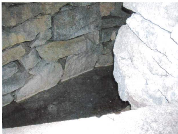
Intérieur du captage (galerie)
