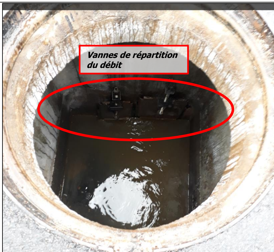
FIGURE 10 – APERÇU DU VANNAGE AU NIVEAU DE LA DEFLUENCE DU GUILLON A VOIRON
