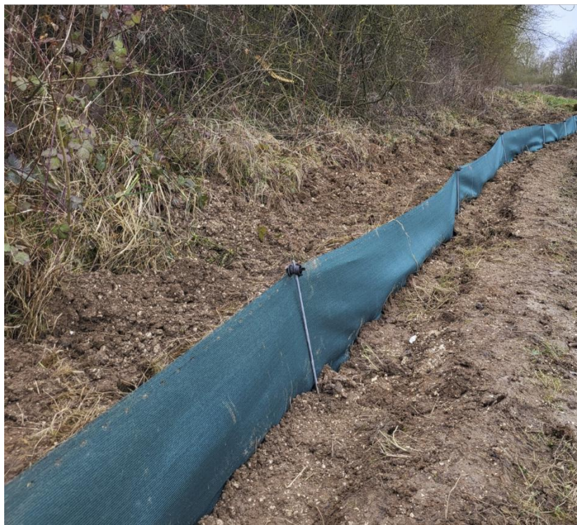
Figure 19 : Barrière de protection pour amphibien
