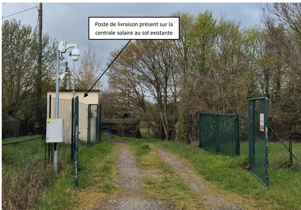
Illustration 10 : Poste de livraison existant
