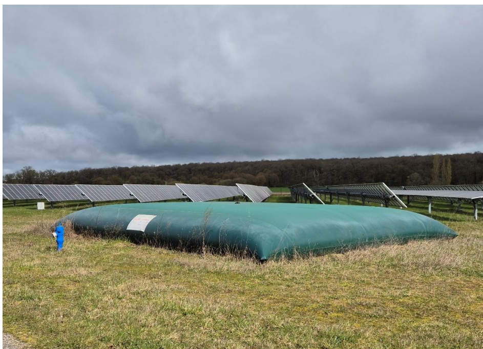
Illustration 7 : Citerne souple autoportante d'eau de défense incendie
