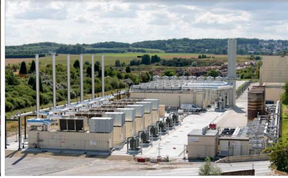
Plateforme de valorisation du biogaz (NPNT, p.35)
