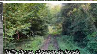
Chemin en déblais, boisement en taillis dense, absence de fossés
