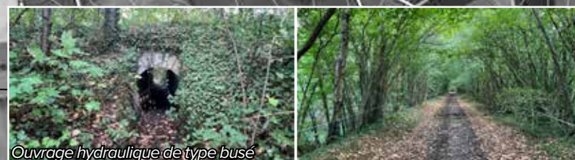
Chemin en déblais, couvert arboré en taillis + absence de fossé
