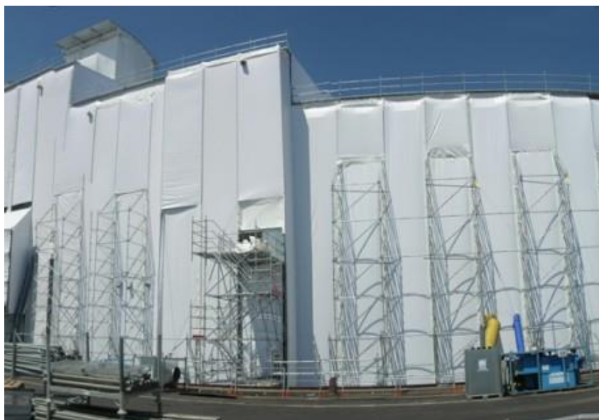
Figure 13 : Exemple de filet de sécurité pour échafaudage (source : banderolestop.fr)
