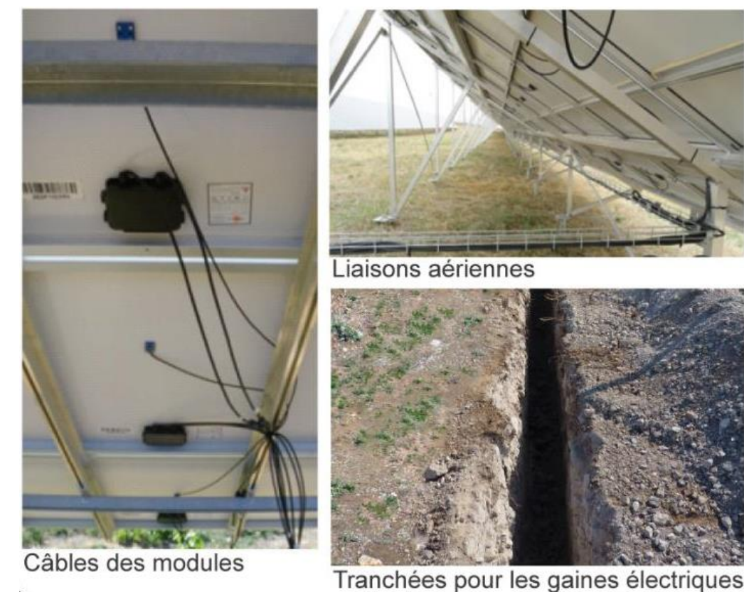
Photographie 3 : Liaisons électriques (Source : ENCIS Environnement)
