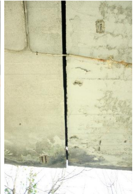
FIGURE 36 : DISJOINTEMENT DE MAÇONNERIE EXTERIEUR FAVORABLE AUX PIPISTRELLES
