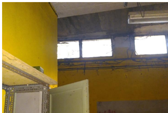
INSTALLATION D'UN BOITIER PASSIF SMBAT MINI AU NIVEAU DU TRANSFORMATEUR ELECTRIQUE A L'EST DU BATIMENT (18/08/2025)
