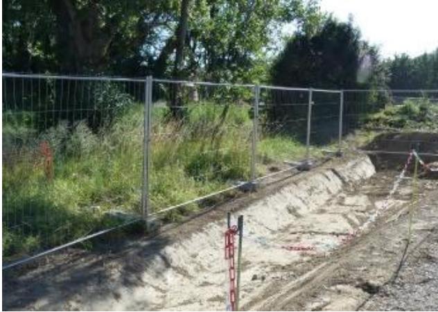
FIGURE 60 : BARRIERE DE CHANTIER MOBILE (HERAS)
