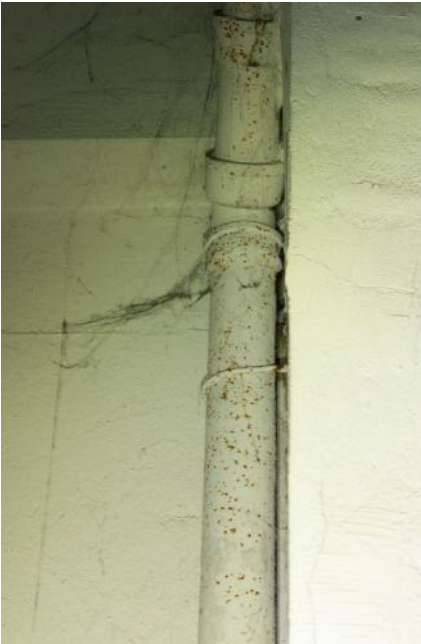
FIGURE 32 : ESPACEMENT ENTRE LES MURS ET LES TUYAUTERIES OFFRANT DES GITES FAVORABLES AUX MURINS DE PETITE TAILLE
