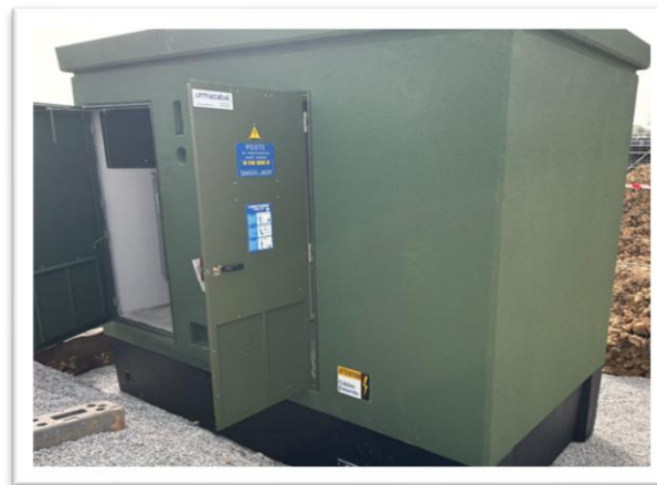
Poste de transformation
