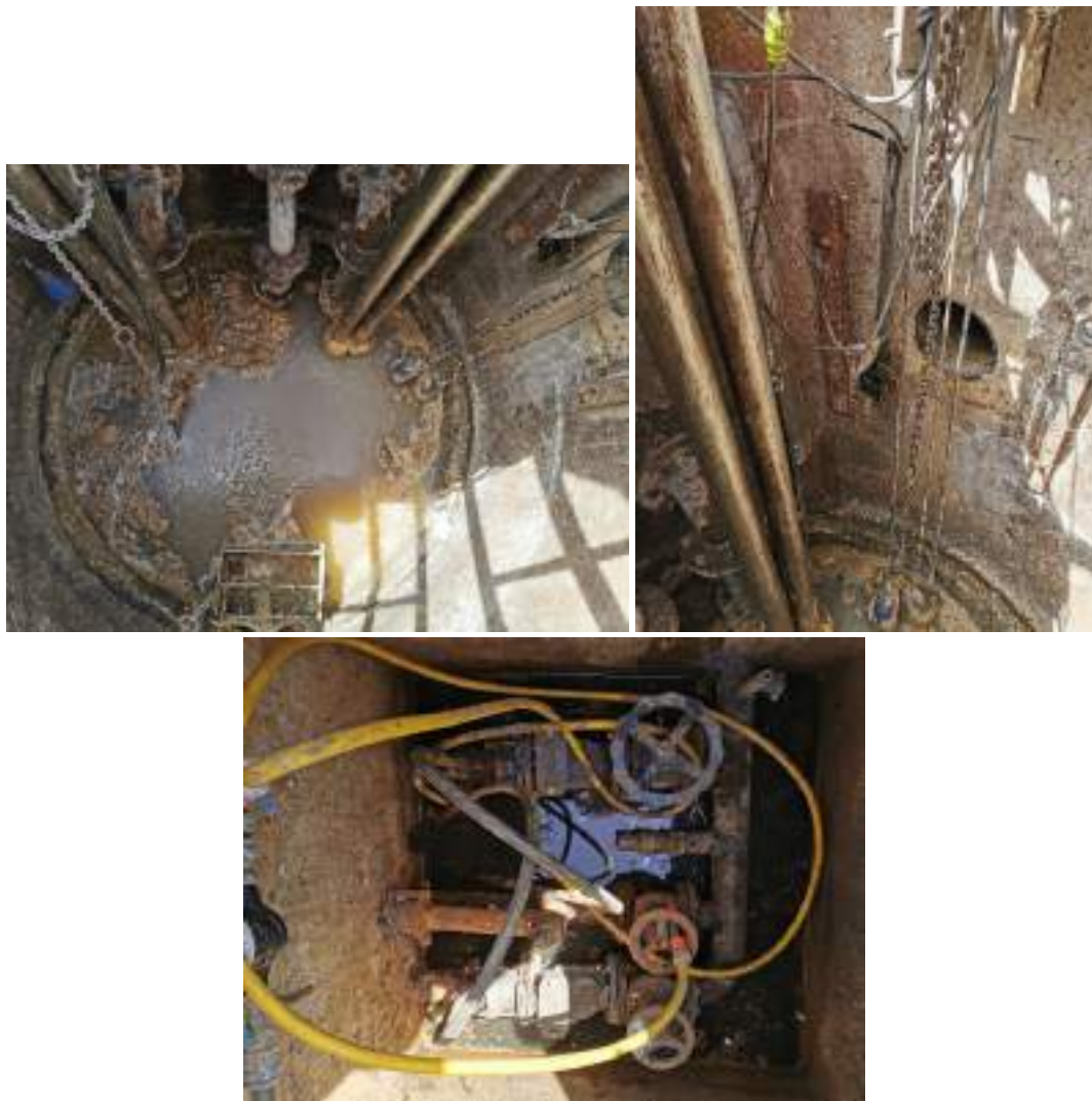
Figure 5 : Bâche, trop-plein et chambre à vannes du PR
