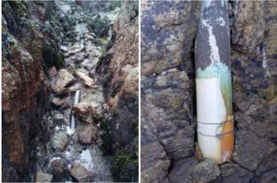
Figure 9 : Point de rejet : Rejet visible à coefficient 78 (photo1), réparation ponctuelle en bas de falaise (photo 4)
