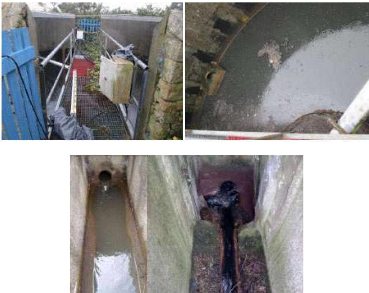
Figure 8 : Station d'épuration , canal de d'entrée (image 4), canal de sortie (image 5)
