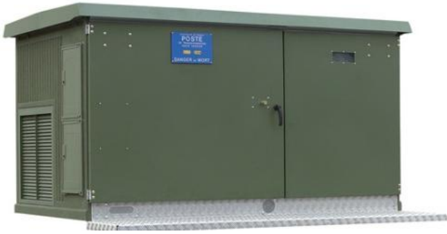
Figure 8 : Exemple d'un poste de transformation (source : groupe Cahors)
