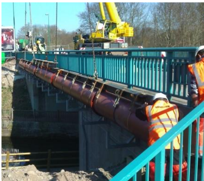
Figure 34. Exemple d'un réseau posé en encorbellement
