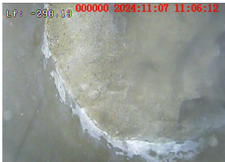
Figure 19: Pot de décantation partiellement cimenté
