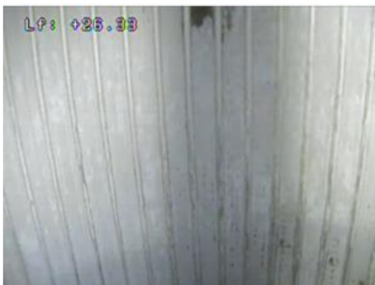
Figure 13: Présence de laitance de ciment sur la partie crépinée à 26m de profondeur (forage F3)
