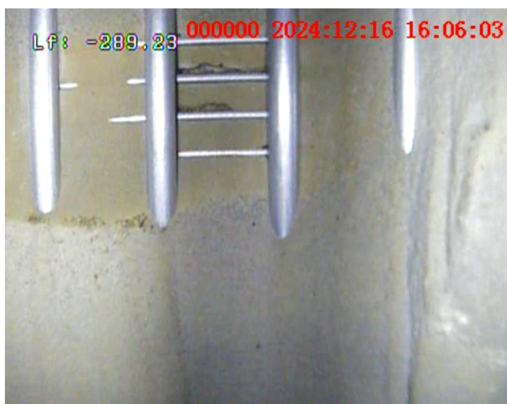
Figure 14: Dépôt conséquent de ciment à la base de la crépine (forage F1)
