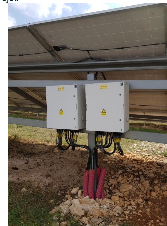
Figure 8: onduleur string (source TSE)
